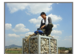
ガス抜き管からのガス サンプリングの様子
