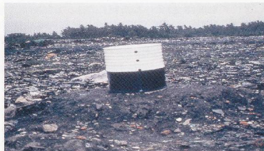
廃ドラム缶を使ったガス抜き設備
