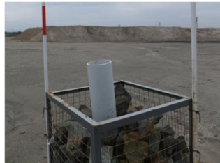
(a) ガス抜き管における無孔管
