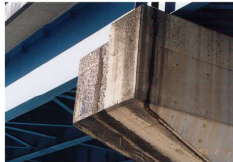
写真1.1.4 橋脚のスケーリング
