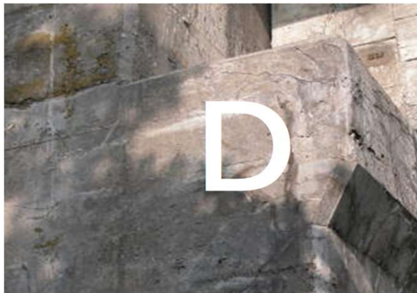
写真 1.1.8 橋台のDひび割れ(1)
