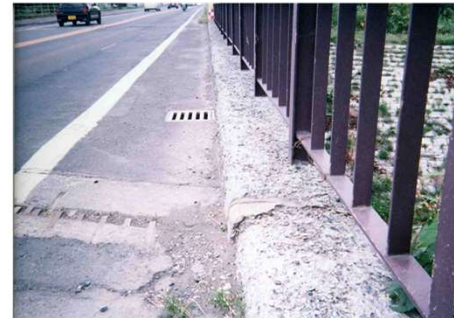
写真1.1.5 地覆のスケーリング
