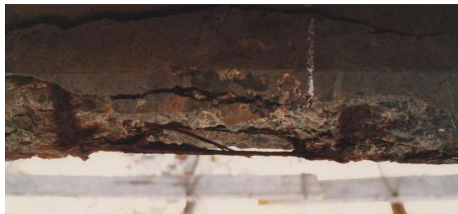
コンクリート梁の鉄筋破断 rupture of reinforcement in concrete beam
