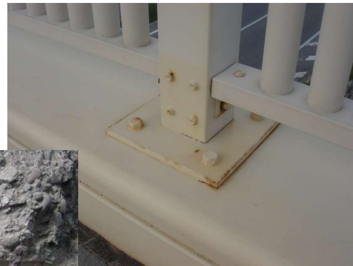
ステンレスボルト の腐食 (FRP橋 の高欄) corrosion of stainless steel bolt in FRP bridge
