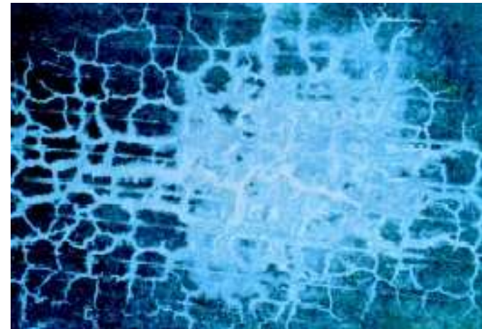
コンクリート床版 の疲労ひび割れ Fatigue crack in concrete slab
