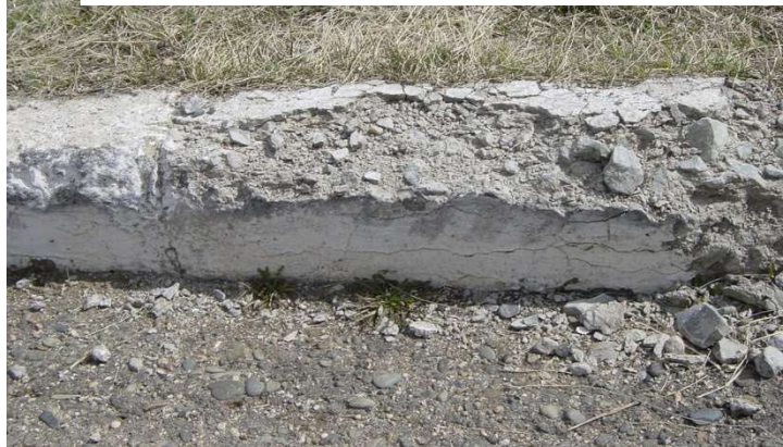
コンクリートの剥落 scaling (flaking) of concrete
