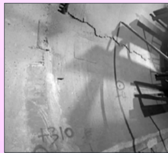
(5) 二次衬砌开裂
