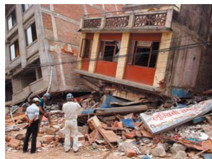
図1 2015年ネパール・ゴルカ地震によるカトマンズ市内の建物被害調査
