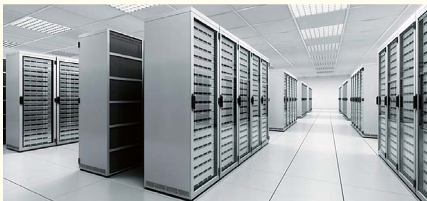
▲ICT装置用ラックが並んだデータセンター 提供:(株)NTTファシリティーズ
