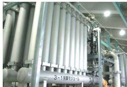
図2 分離膜を使った浄水場 (円筒形ステンレス圧力容器の中に分離膜が格納され、ろ過を行っている) Figure 2: Membrane water treatment plant (water is filtered through membrane housed in cylindrical stainless pressure vessels)
