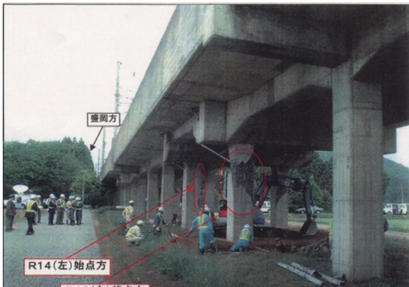
三陸南地震（2003）による損傷
