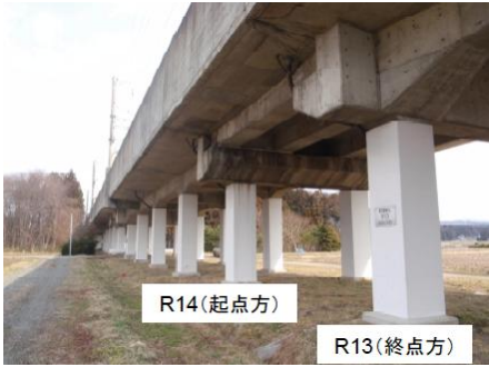
東北地方太平洋沖地震後の様子
