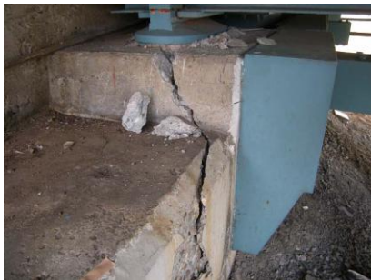
コンクリート製の 支承台座の破壊
