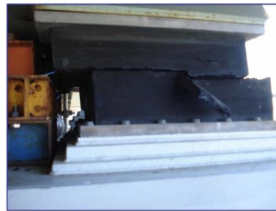
ゴム支承の破断
