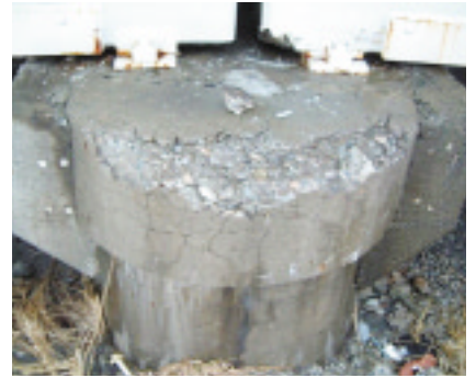
図1 コンクリート製橋脚の凍害 (提供: (独) 土木研究所寒地土木研究所)
